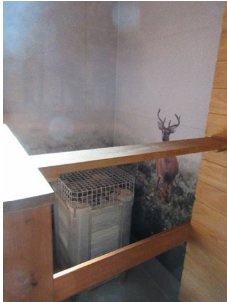
Kuva: Saunan pesuhuoneen suihkut ja kiukaan taustakuva
