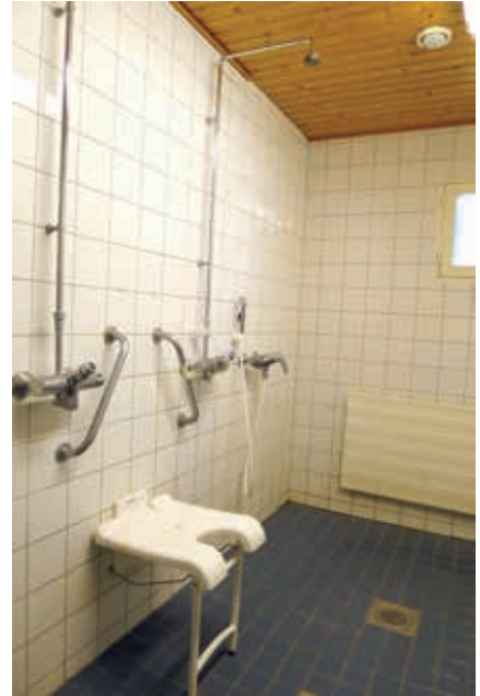
Yhteisessä suihkuhuoneessa oleva suihku-istuin.
